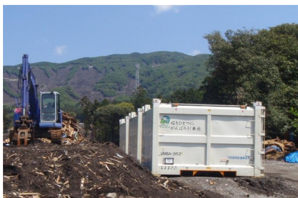
図３－３ 被災現場コンテナ積込風景
