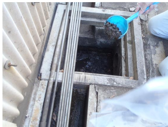
図3(2) 雨水枡の泥溜まりでの濃集(蓄積)
