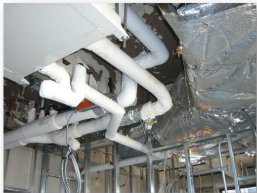
VAVエアハンドリングユニット
