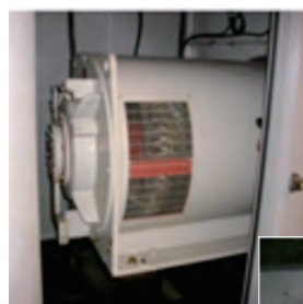
コージェネレーション設備
