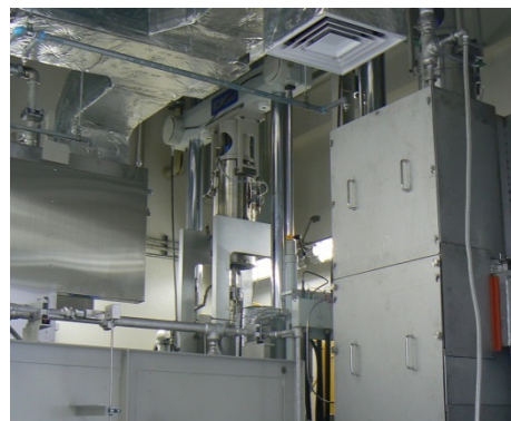
圧力容器部分
