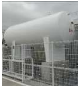
液化水素貯槽
