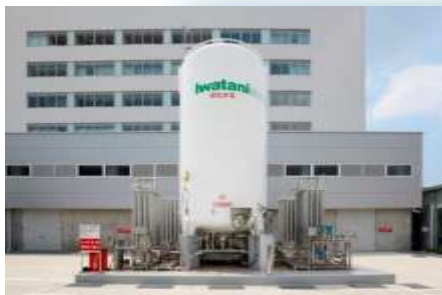
液化水素供給設備 (中央研究所共用)
