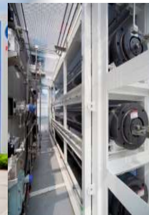
蓄圧器ユニット
