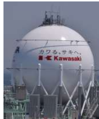
国内最大 液化水素タンク (神戸液化水素荷役ターミナル)
