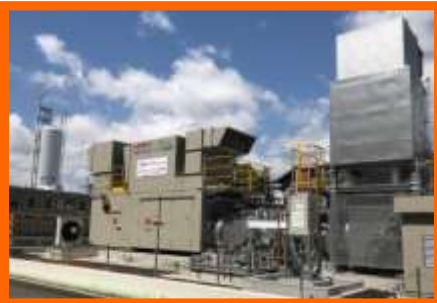
水素CGS エネルギーセンター
