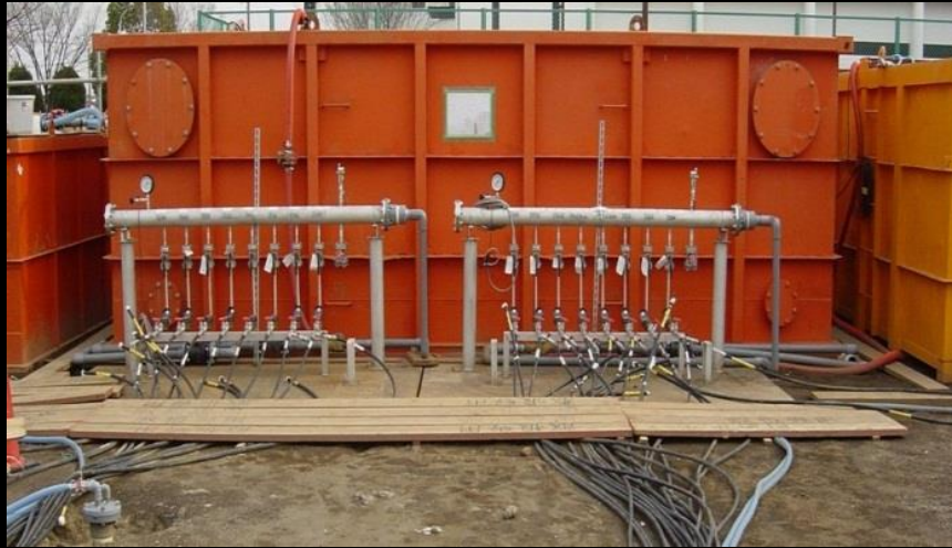
栄養剤注入設備
